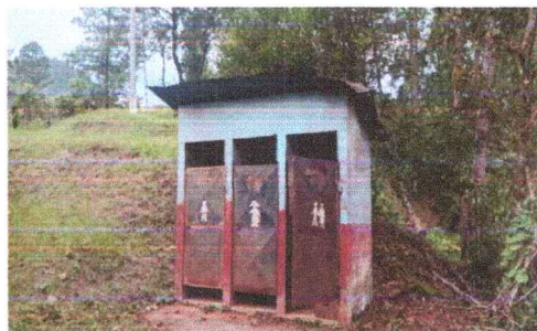
Foto 4: Puertas y techo de letrinas en mal estado.
