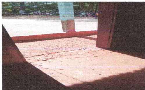
Foto 2: Piso de concreto en mal estado.
