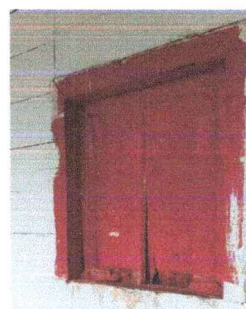
Foto: Ventana de madera deteriorada.
